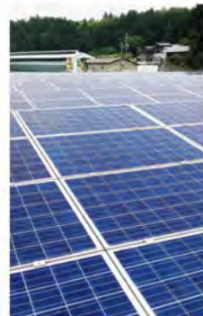
奈良・天理太陽光発電所
