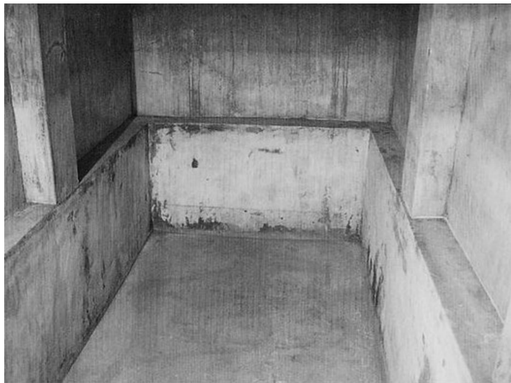
コンクリート製の地下防空壕（堺市堺区甲斐町東 山之口商店街内） 写真提供：ギャラリーいろはに
